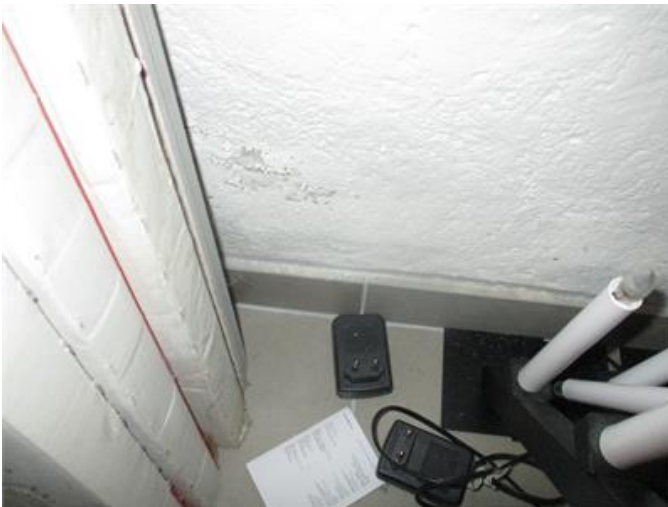
Fuktgenomslag på nederkant av källarmur.
