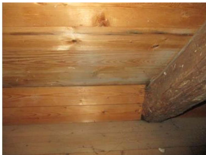
Mikrobiell påväxt på underlagstak på vinden.
