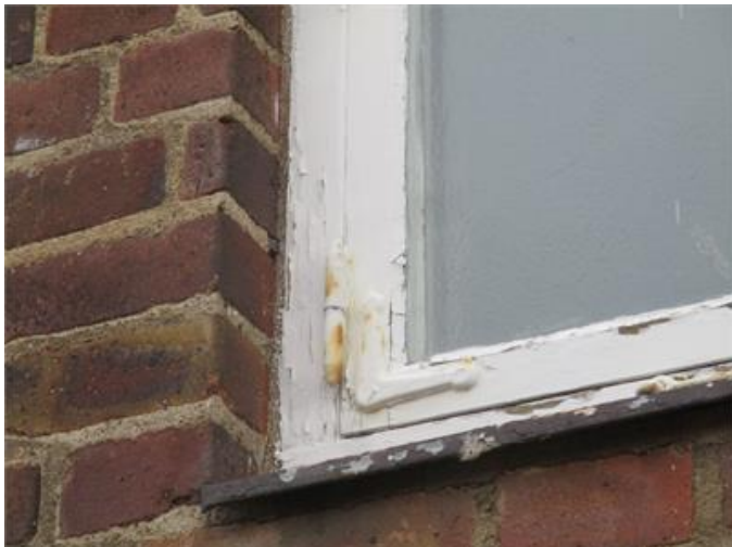
Fönster bristfälligt färgtäckta och rost i gångjärn.
