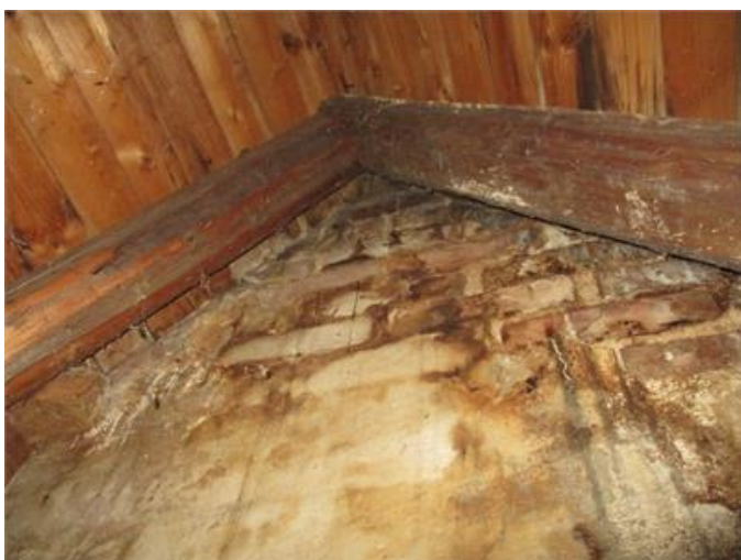
Fuktgenomslag på murstock/skorsten.
