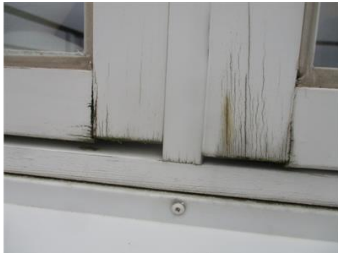
Fönster bristfälligt färgtäckta och bottenbågen kasat ned.
