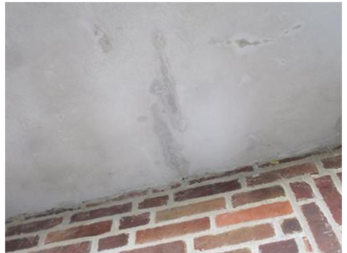
Sprickbildning och fuktgenomslag på undersidan av balkong.
